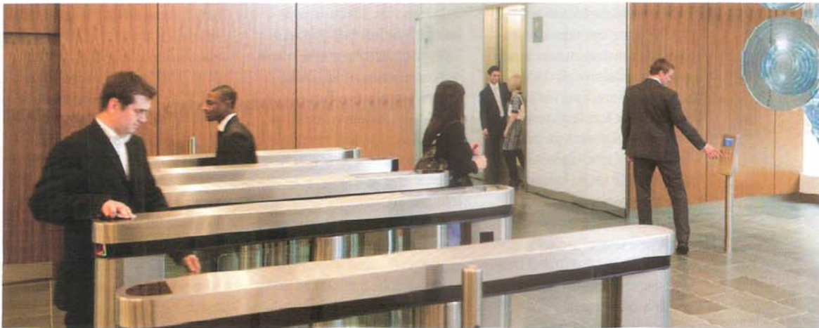
Proje kapsamında turnikelerde ve asansör kontrol paneleri üzerinde bulunan kart okuyucular aracılığıyla Siemens Sipass veritabanından alınan kişilerin çıkabileceği katlar, Kone VKS sistemine otomatik olarak gönderilmektedir.
